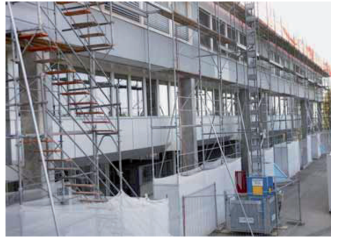
Le collège en chantier. Les vandales ont profité des échafaudages pour commettre des déprédations et dérober du matériel. CÉLINE REUILLE
