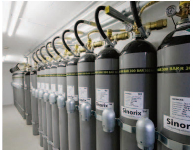
Dans les dix cellules «haute sécurité», l'oxygène peut être remplacé par du gaz, poussé à 300 bars, en 30 secondes. PHOTOS SAMUEL FROMHOLD
