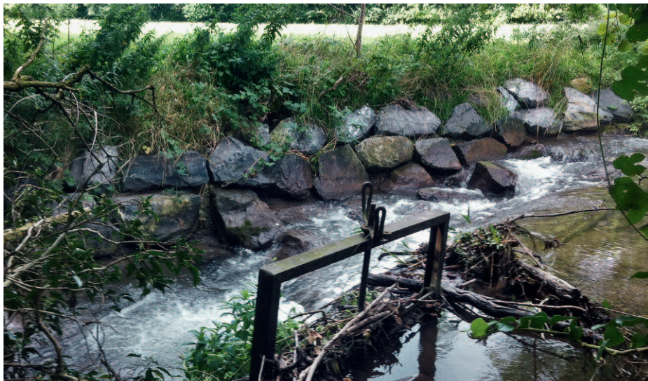
Un des différents aménagements réalisés: Amélioration d'une rampe existante avec captage d'eau.
